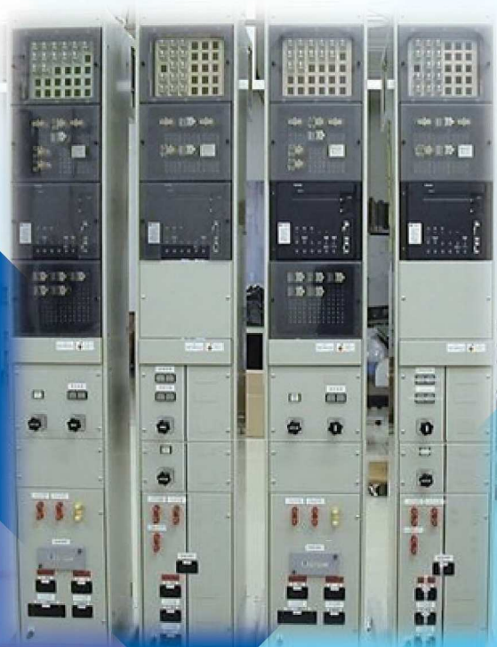
送電線保護継電装置
